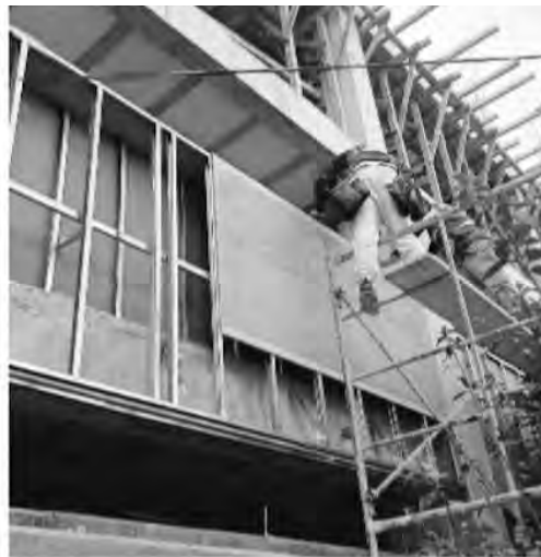
· La obra excede los niveles permitidos
