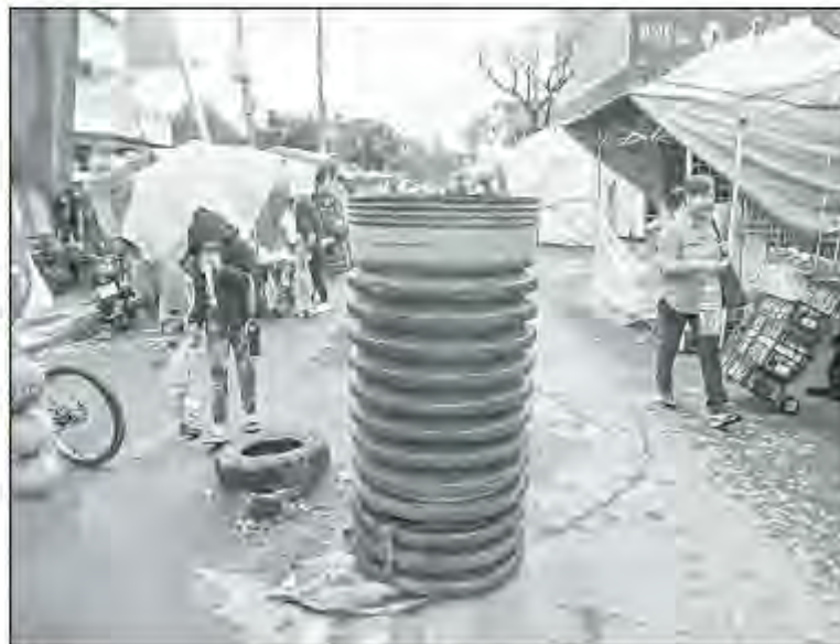
▲ ► Hundimientos en Oriente 108 y Sur 161, y en Oriente 106 y Sur 159, colonia Bramadero, alcaldía Iztacalco. Fotos Víctor Camacho
