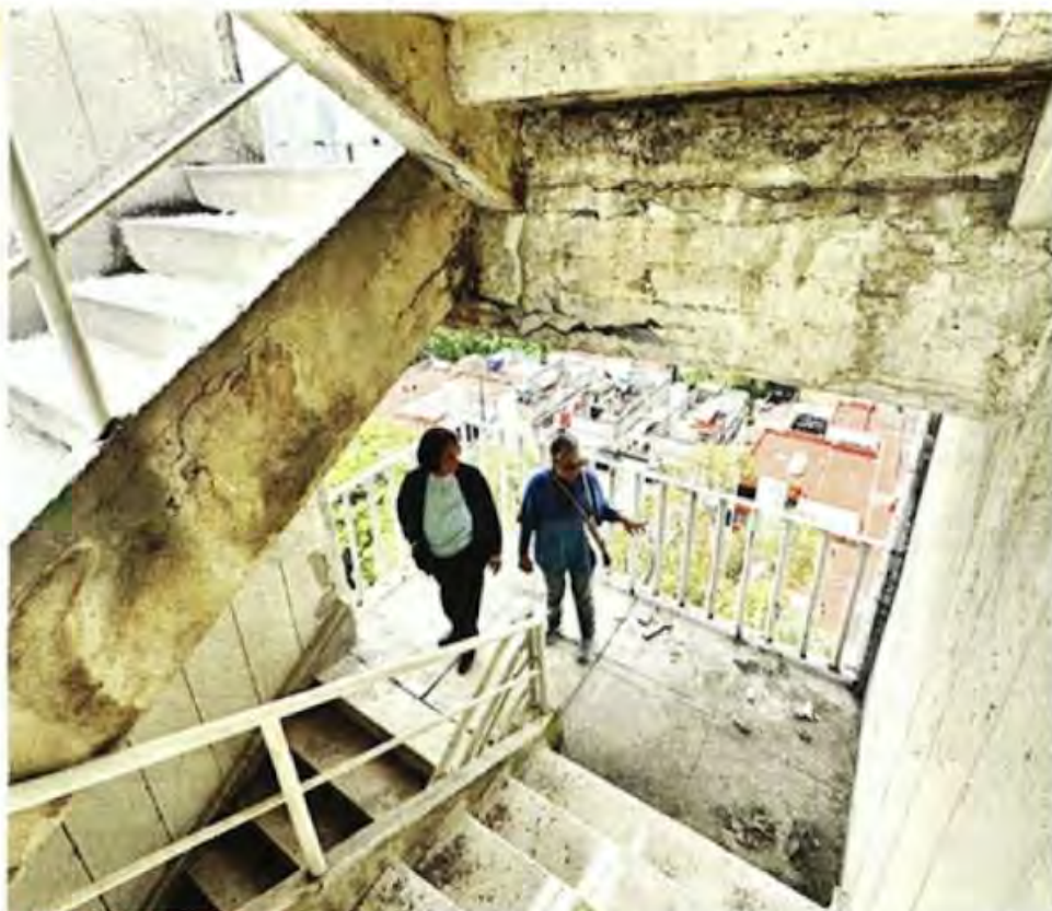
ARRASTRAN RIESGO. Vecinos buscan realizar obras en las escaleras fracturadas del Edificio G de la unidad habitacional de la Alcaldía Benito Juárez.
