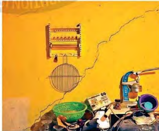
El hogar de doña Isabel y don Víctor presenta daños en paredes, pisos, patio y losas, como resultado de los temores con los trabajos de construcción
