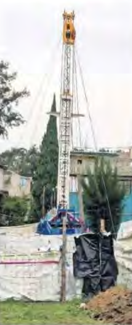
Los pozos de infiltración ayudan a mitigar los encharcamientos por lluvias y recargar el acuífero.
