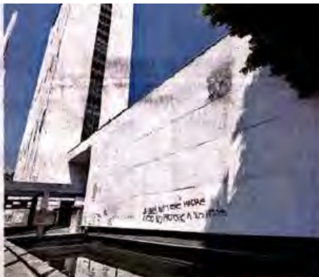
■ La UNAM condenó la violencia y consideró una afrenta los daños al espacio que nació como Memorial del 68.
