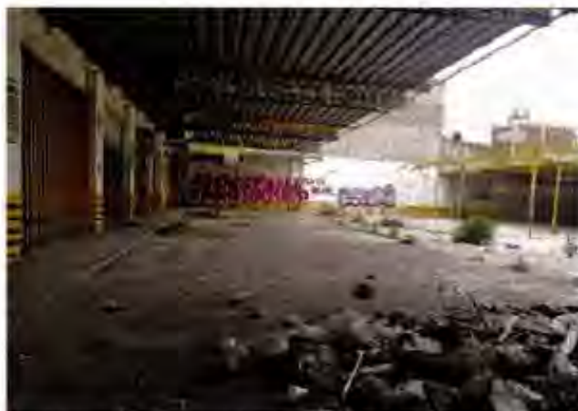
El interior luce deteriorado debido que los operadores del estacionamiento fueron desalojados.
