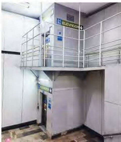
En la línea B no funcionan tres equipos de
