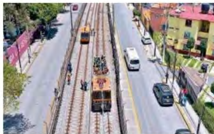
También los postes de soporte del cableado se vieron afectados
