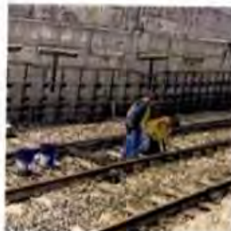
Varias estaciones de la Línea A del Metro sufrieron afectaciones.
