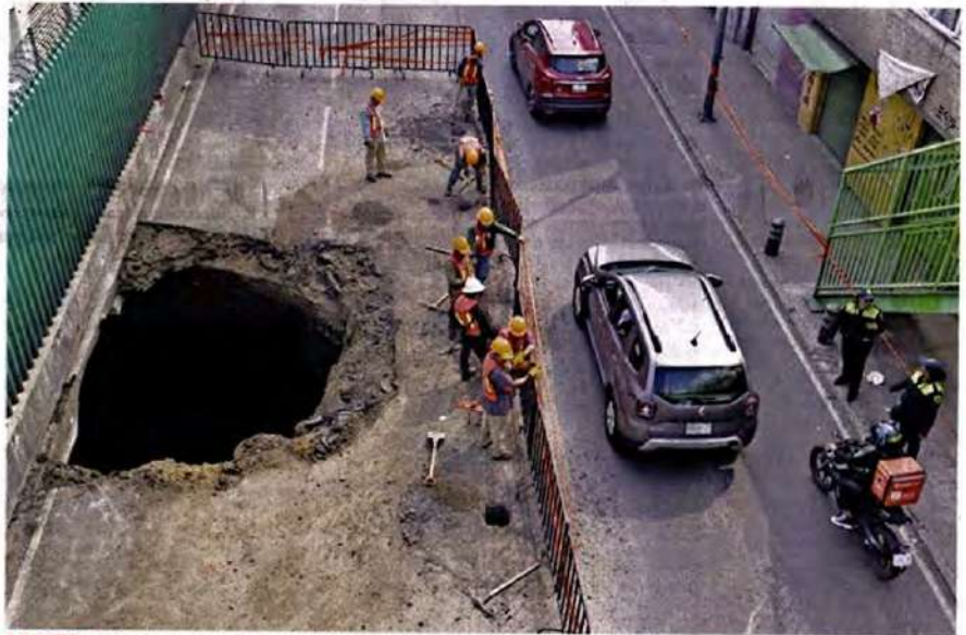
AGOSTO. En Periférico Oriente, también en Iztapalapa, un socavón se abrió ante el paso de un camión materialista.
