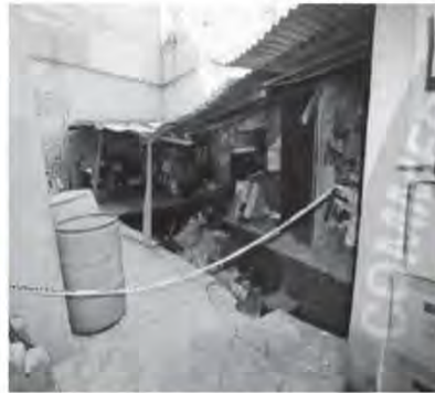
El socavón se formó al interior de esta vivienda
