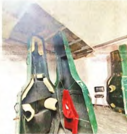
El deterioro afecta también el resguardo de instrumentos, tanto propiedad de la OFCM como de los músicos.
