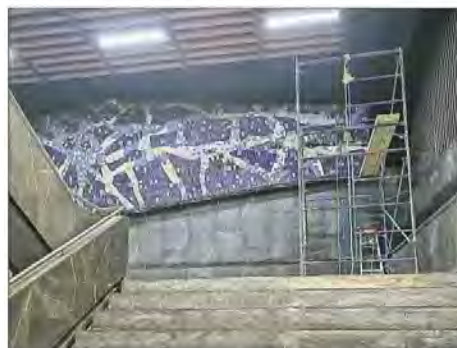
▲ En un recorrido que hizo este diario se constató que la pieza está desprotegida y que los trabajos incluyen estructuras de madera y un andamio que obstruye el paso peatonal. Foto Daniel López
