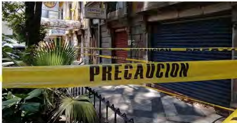
Edificio dañado por el terremoto de 2017 en el Centro Histórico de la Ciudad de México.
