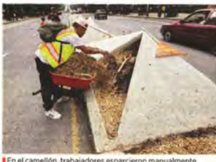
En el camellón, trabajadores esparcieron manualmente el material orgánico que humedecerá la tierra.
