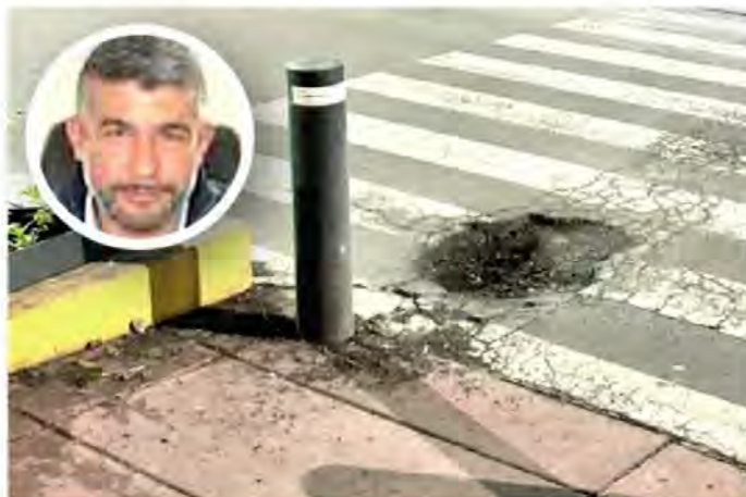
Abundan roturas y demás signos de desgaste
