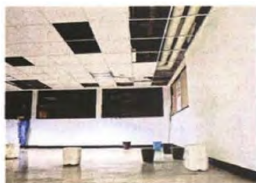
Cables y tubería expuestos, fallas de luz y muchos contenedores para las goteras se ven en los pasillos.
