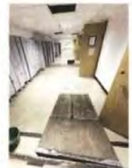
En los pisos colocaron cubetas y protectores ante el agua que ingresa.
