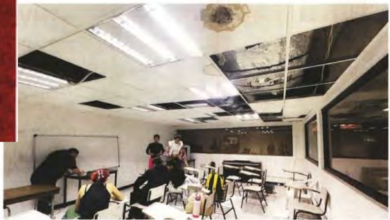
HUMEDAD. Alumnos señalan que, ante la falta de atención al Centro Cultural, los techos y paredes se caen a pedazos.
