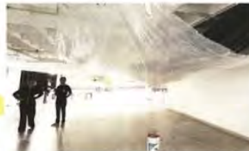
Trabajadores han optado por colocar plástico en algunas zonas para hacer frente a las goteras que se han formado.
