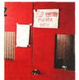
Hay cerraduras que se rompieron y puertas que no funcionan.
