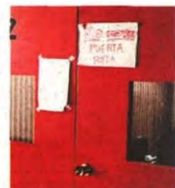
Hay cerraduras que se rompieron y puertas que no funcionan.
