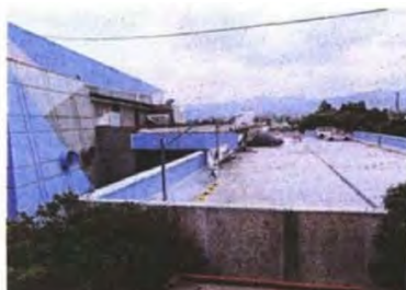
Otro gran problema es que sobre el techo de la escuela está el estacionamiento, que ya ha afectando la estructura.
