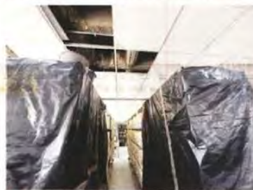
Las estanterías de la biblioteca fueron cubiertas con bolsas para evitar que los libros se mojen ante filtraciones.
