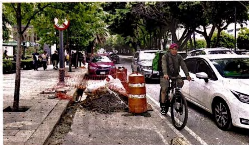
EN RIESGO. Los montículos de tierra obligan a los pedalistas a desviar su trayecto y circular en los carriles de automotores.
