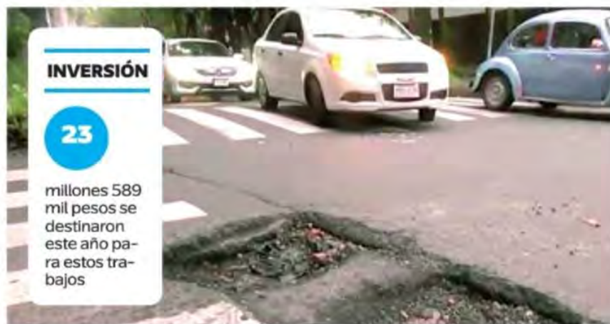
En varias zonas de la demarcación se observan estos problemas
