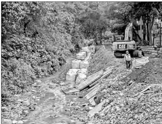
▲ Enormes costales con arena y grava contienen el potencial deslizamiento en la colonia El Pirú. Foto Jair Cabrera Torres
