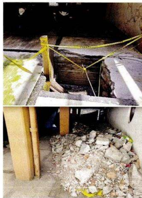
■ Cascajo y agujeros quedaron en el edificio luego de que las obras de rehabilitación fueron frenadas por un amparo.
