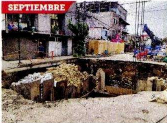
■ La dimensión de la oquedad aumentó durante los trabajos, por lo que vecinos fueron desalojados.
