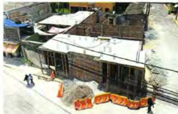
Algunas de las viviendas que van a ser reparadas continúan en obra negra, a la espera de que lleguen los recursos para los trabajos.
