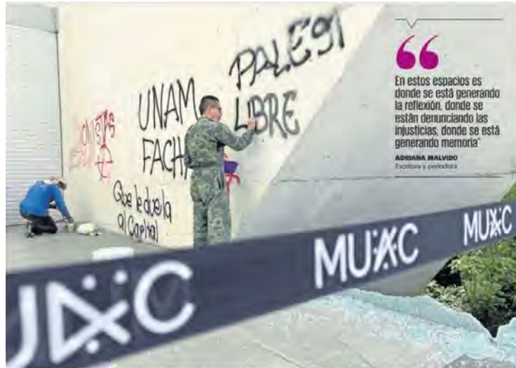
Tras los daños en la fachada y la entrada del Museo Universitario Arte Contemporáneo (MUAC) del Centro Cultural de la UNAM, hoy equipos de personas trabajan a toda marcha para arreglar el inmueble antes de que el recinto abra sus puertas de nuevo; para borrar esas pintas utilizan una catapa y producto con una base química.
