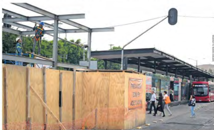
Al exterior de la estación permanecen colocados paneles de madera que delimitan el área de obra, mientras trabajadores realizan estructuras metálicas.
