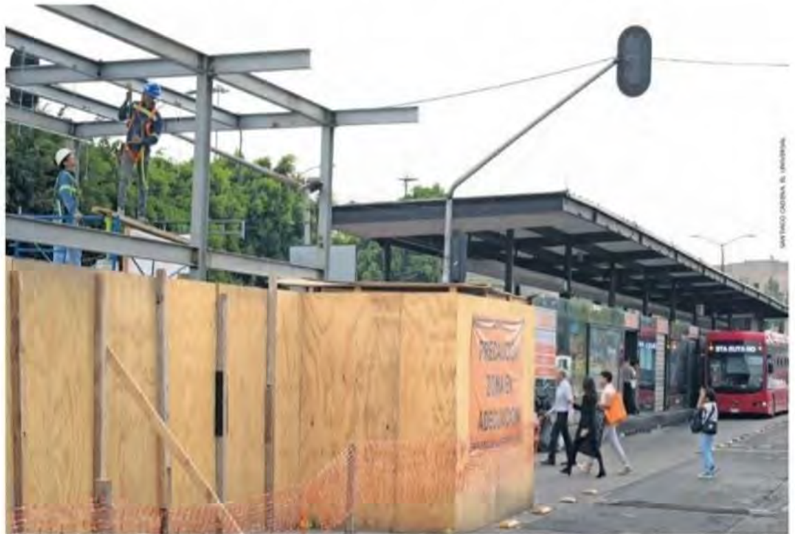
Al exterior de la estación permanecen colocados paneles de madera que delimitan el área de obra, mientras trabajadores realizan estructuras metálicas.
