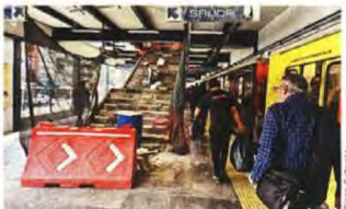
En la estación Viaducto de la Línea 2, usuarios conviven entre las obras que se realizan en el andén.
