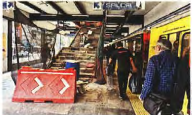
■ En la estación Viaducto de la Línea 2, usuarios conviven entre las obras que se realizan en el andén.
