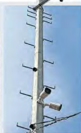
Cada Sendero Seguro cuenta con cámaras fijas, alarma y botones de pánico.
