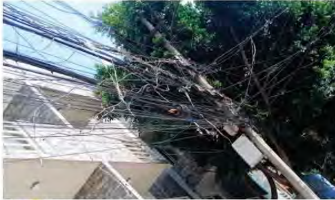
En la CDMX hay alrededor de 30 mil toneladas de cableado suspendido, de las cuales aproximadamente 65 por ciento es obsoleto.
