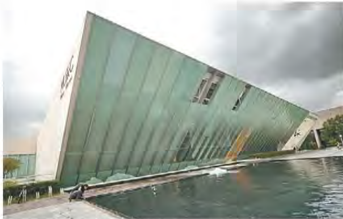
Daños en la fachada del MUAC. ARACELI LÓPEZ
