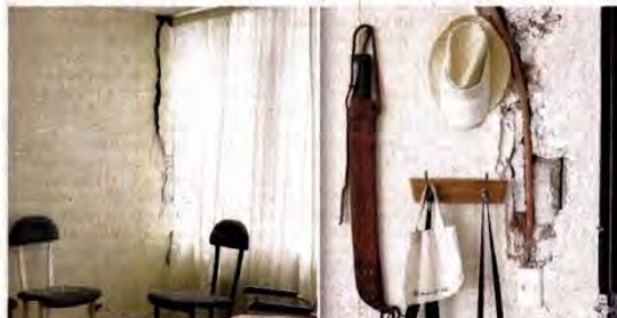
■ Sólo nueve familias viven al interior del edificio, las grietas permiten ver los tabiques y hasta el cableado de luz eléctrica dentro de los departamentos.
