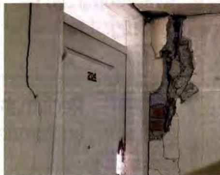
■ Cuarteaduras atraviesan fachadas, cornisas y muros del inmueble ubicado en Aguascalientes 12.
