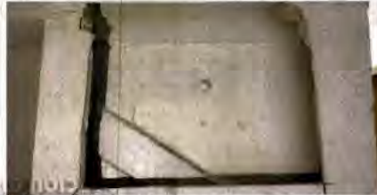
■ Buscan que especialistas evalúen si el edificio ubicado en la Colonia Atlampa aún puede ser habitable.
