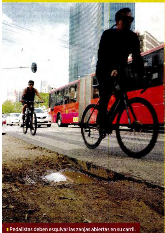
Pedalistas deben esquivar las zanjas abiertas en su carril.
