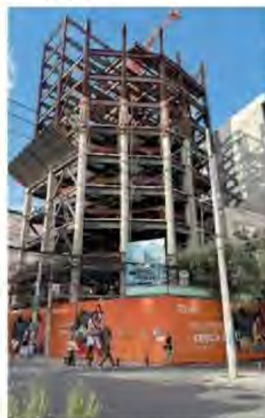
EDIFICIO en restauración dañado en el sismo de 2017, ubicado en Sonora 149.
