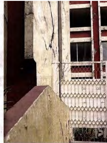
■ Los daños lucen alrededor de puertas, barandales y accesos.
