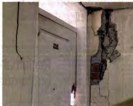
■ Cuarteaduras atraviesan fachadas, cornisas y muros del inmueble ubicado en Aguascalientes 12.
