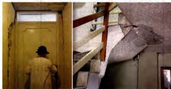
■ Aunque un dictamen afirmó que la estructura del edificio es segura y no hace falta una demolición, vecinos conviven con filtraciones severas en escaleras y acabados.
