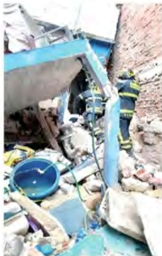
Quedó totalmente destruida
