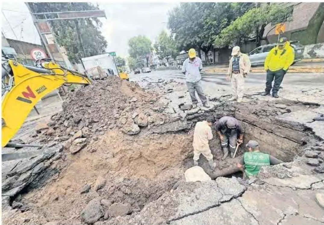
Frente a la Plaza de Toros México, en el cruce con las calles Baltimore y Holbein de la colonia Ciudad de los Deportes, la presión del agua rompió el pavimento en al menos dos carriles del Eje 6 Sur por lo que hubo afectaciones a la vialidad.
