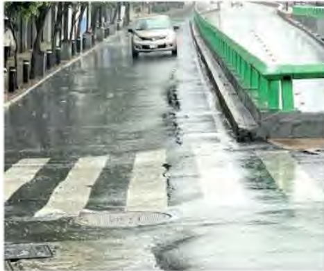
· Hay grietas en el asfalto
