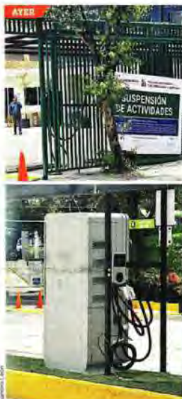
RIESGO. Aún en construcción, la estación daba servicio. Ayer lucía los sellos de PAOT.
