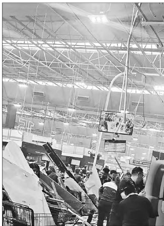
▲ La caída del falso plafón de unos 80 metros en una tienda de autoservicio en Pabellón del Valle dejó el saldo de una persona lesionada y otra atendida por crisis nerviosa. Foto La Jornada
