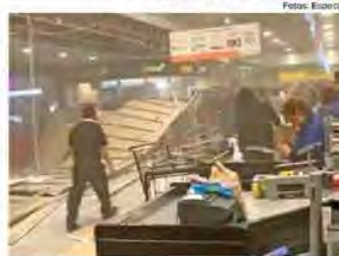
De acuerdo con las autoridades, el desprendimiento del falso plafón fue por una mala instalación y falta de mantenimiento.
