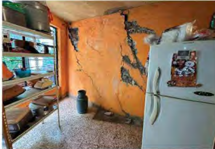
LA VIVIENDA de Daniel Díaz, en el Paraje Zacatepec, luce con grietas en sus muros y pisos, ayer.
