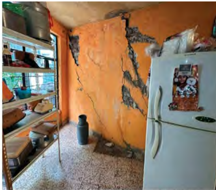
LA VIVIENDA de Daniel Díaz, en el Paraje Zacatepec, luce con grietas en sus muros y pisos, ayer.
