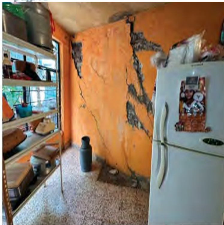
LA VIVIENDA de Daniel Díaz, en el Paraje Zacatepec, luce con grietas en sus muros y pisos, ayer.
