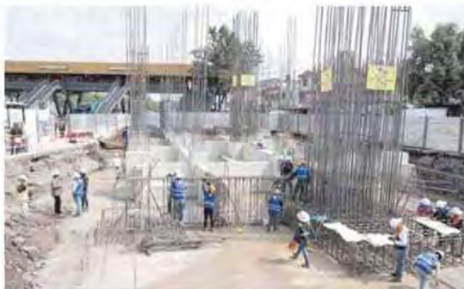
Señalan los vecinos que podrían haber daños en sus casas.
