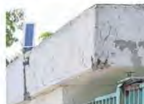
Tras nueve años cerrado, la estructura presenta grietas y la pintura se desprendió de las paredes.
