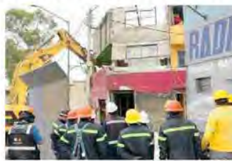
En la zona donde estaba la taquería La Bajadita empezaron a laborar integrantes de la Sobse y de Protección Civil.
