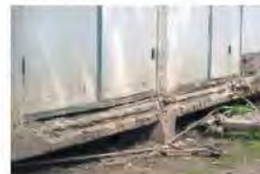
La unidad permanece cerrada desde el sismo de 2017 por los daños en la estructura del edificio, señala informe.
