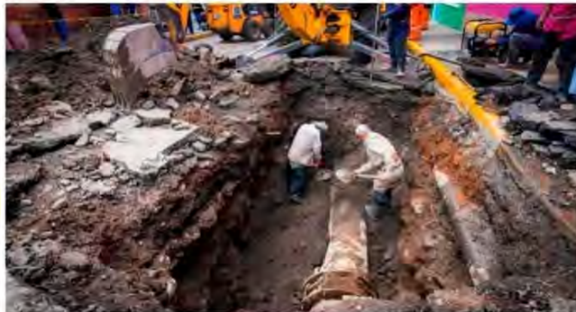
La fuga provocó que 21 familias resultaran afectadas
