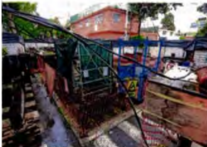
Vecinos de Álvaro Obregón acusan hundimientos por las obras de la ampliación de la Línea 12.
