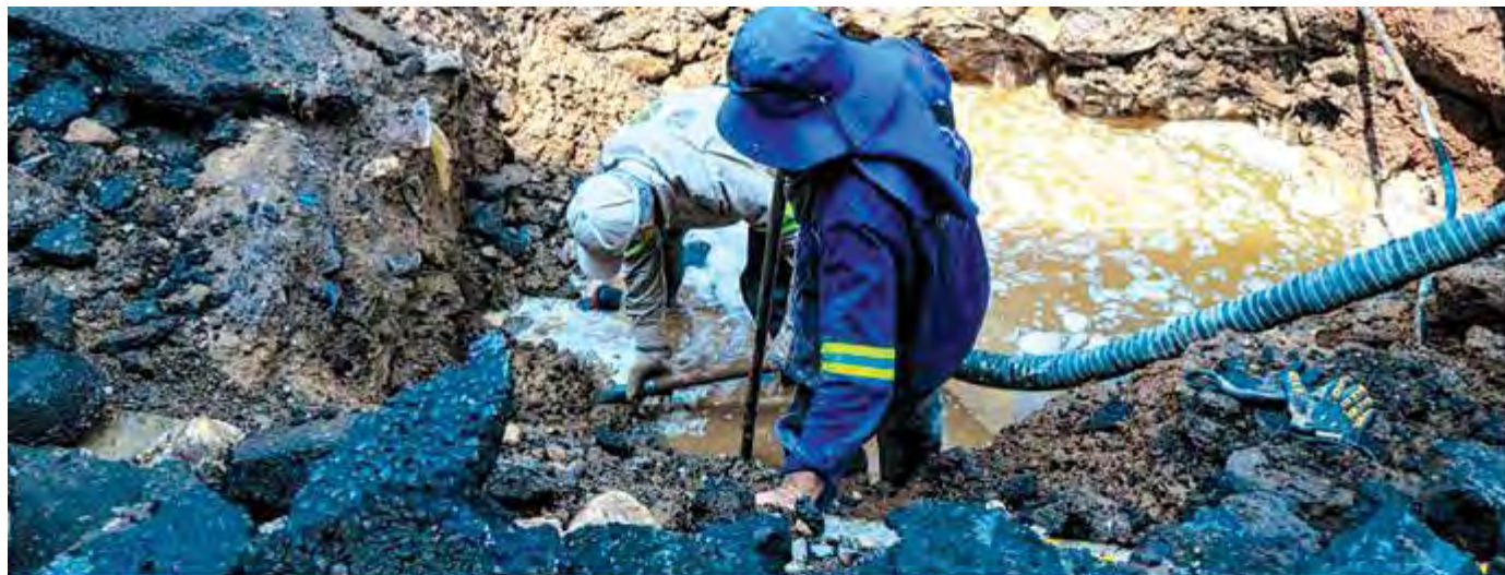
El agua de la tubería ingresó a ocho predios y afectó los muebles de 21 familias que fueron atendidas por autoridades de la alcaldía.
