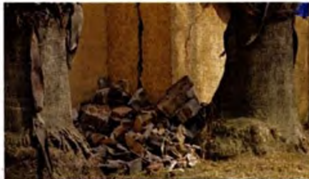
■ En algunas zonas la barda comenzó a romperse, provocando que fragmentos de escombros cayeran del lado del parque.
