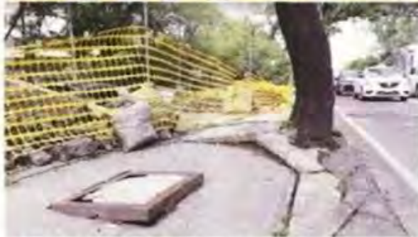
■ Para cubrir los desperfectos en la vía, han sido colocados láminas para tapar las oquedades que se han formado.
