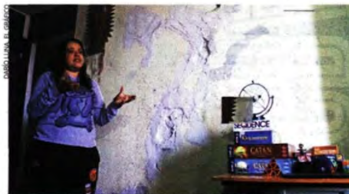
Mercedes, en el 5o. piso, dice que una y otra vez ha tenido que reparar fisuras.
