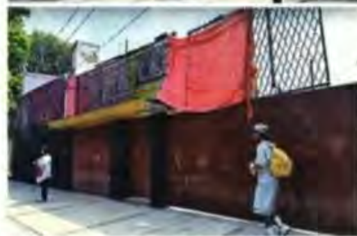
■ Vecinos afirman que la obra en Miramontes ha sido clausurada. En el predio, máquinas y trabajadores siguen laborando.
