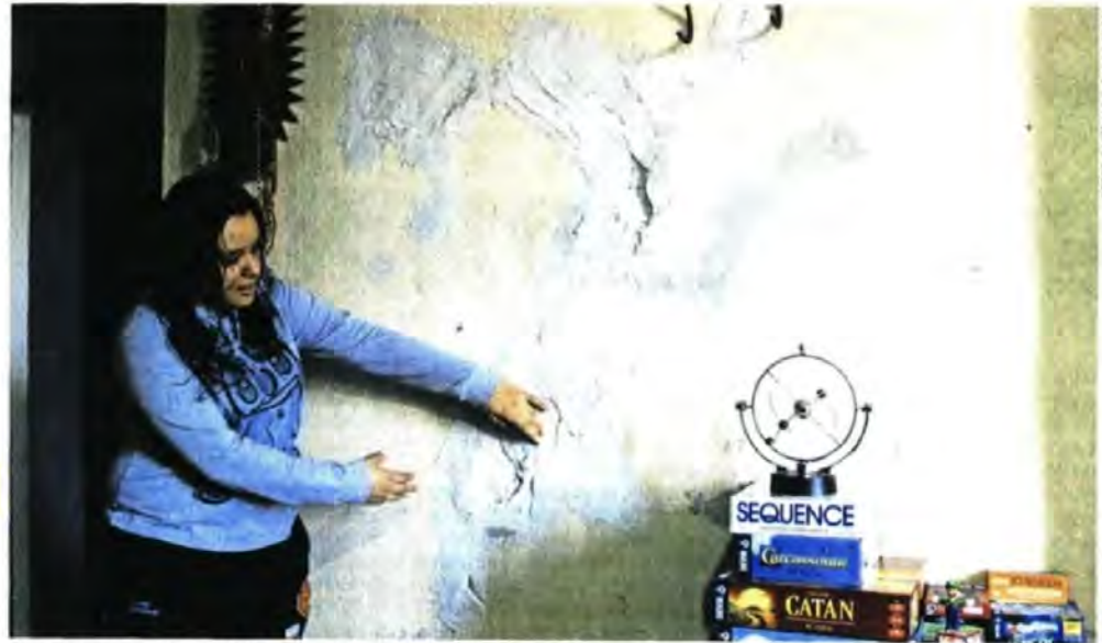
Una grieta recorre la pared del cuarto de Mercedes Aguilar desde el sismo de 2017; a pesar de reparaciones, el daño persiste.
