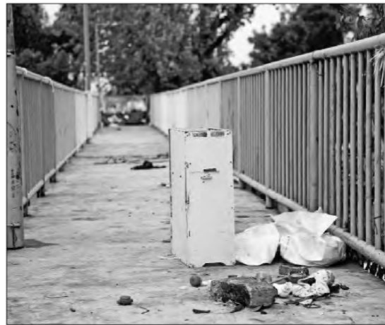
◀ El puente peatonal que atraviesa avenida Del Trabajo, en la colonia Morelos, representa un riesgo para la seguridad de los vecinos por la basura acumulada. Foto Jorge Ángel Pablo García
