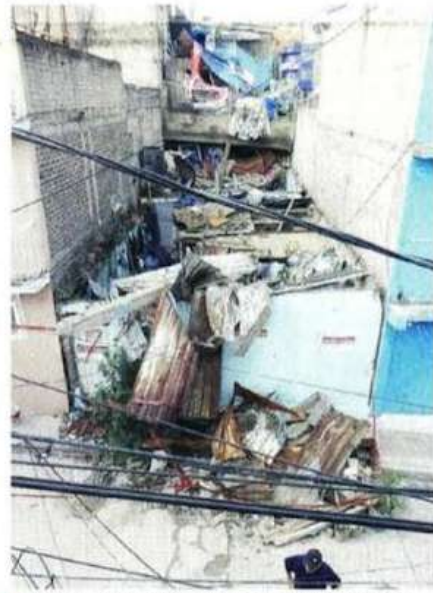
■ Láminas y columnas colapsaron sobre el predio contiguo al sitio donde se registró el estallido.
