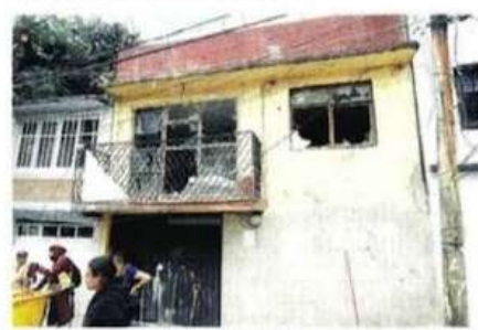
■ Viviendas aledañas a la zona también presentaron daños en ventanas, fachadas y zaguanes
