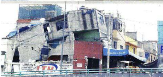
ZONA CERO. La fachada de uno de los inmuebles colapsó parcialmente debido al siniestro.
