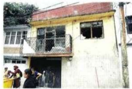
■ Viviendas aledañas a la zona también presentaron daños en ventanas, fachadas y zaguanes
