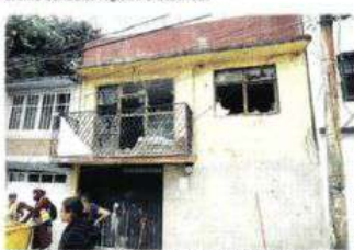
Viviendas aledañas a la zona también presentaron daños en ventanas, fachadas y zaguones
