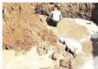
El personal debe extraer el líquido que ingresa a las oquedades durante las lluvias.
