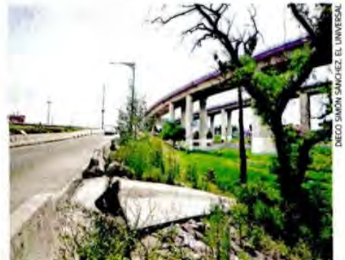
Así luce la zona donde se impactó la pipa hace un año; el muro de contención está mal colocado.
