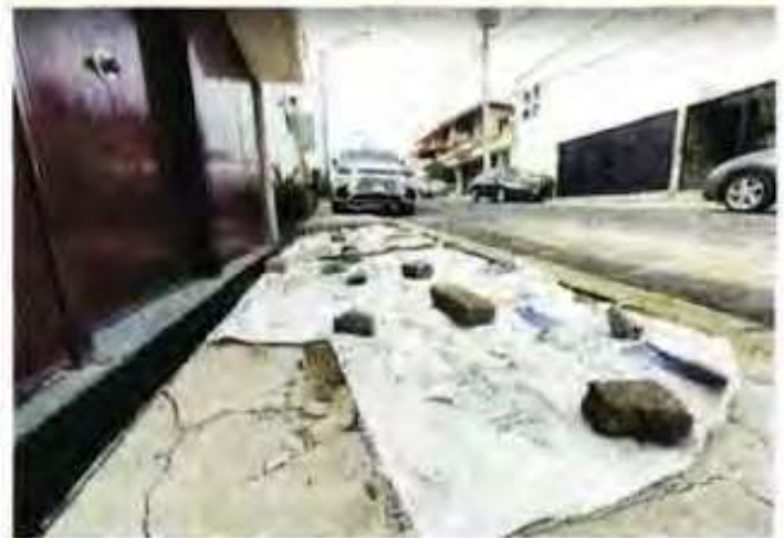
■ La atención a una fuga de agua frente a Calle De las Arboledas 137 dejó las aceras del lugar intransitables.
