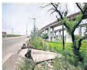
Así luce la zona donde se impactó la pipa hace un año; el muro de contención está mal colocado.
