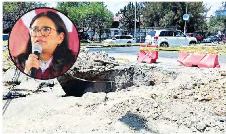
No se ha garantizado el suministro de agua a varias colonias
