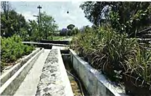
■ El agua tratada que debería regar las plantas por medio de canaletas no llega por una obstrucción en el sistema.
