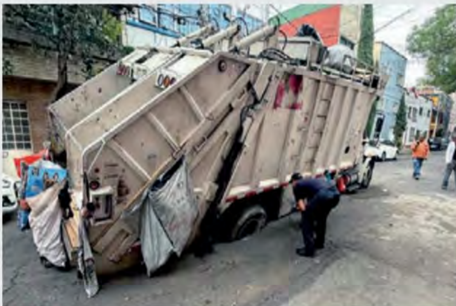
Una de sus llantas traseras cedió al colapsar el pavimento de la calle. Especial
