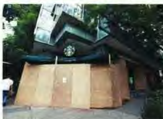
En Calle Amsterdam, el Starbucks que había resultado con daños comenzó a operar tras una mampara.
