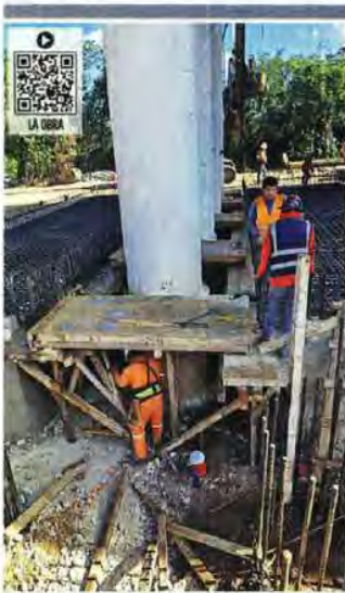
Trabajos de apuntalamiento intentan frenar el hundimiento de pilotes del Tren Maya.
