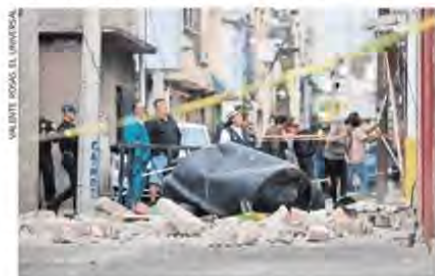
Además del inmueble dañado, algunas casas contiguas y automóviles estacionados en la calle resultaron afectados.
