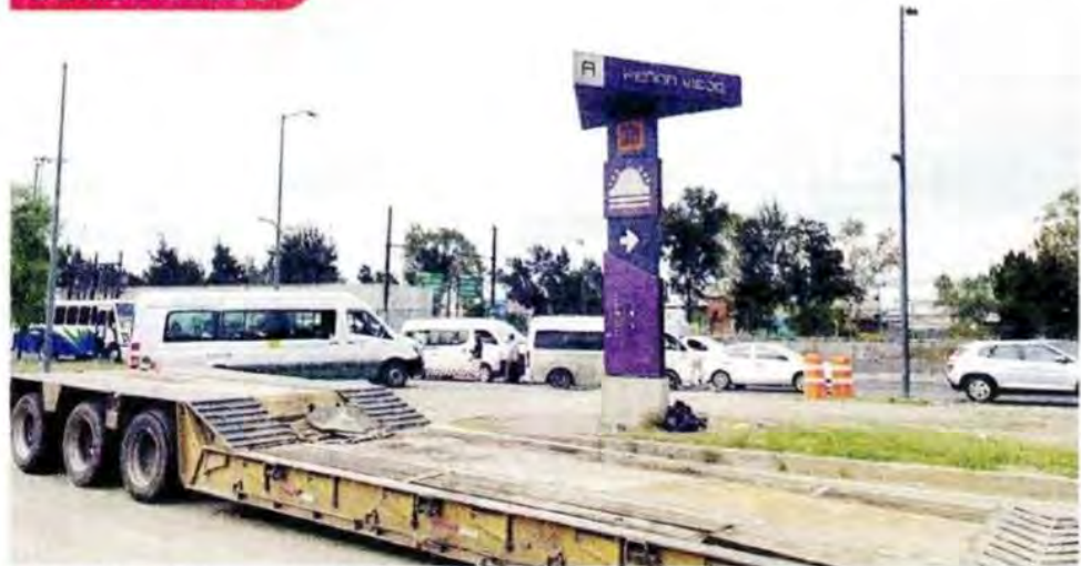
Operadores de transporte público evaden las obras invadiendo el camellón.
