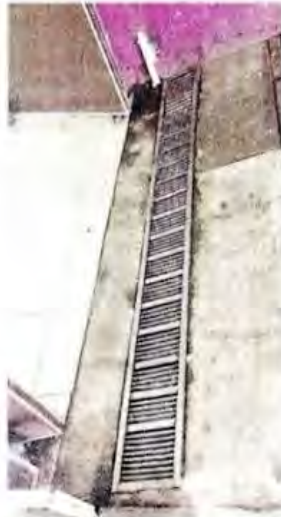
La rejilla del sitio se ve rebasada ante las lluvias.
