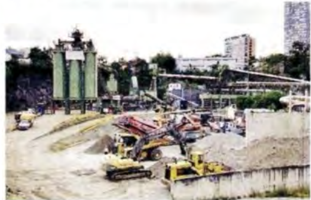
Así luce la Planta de Asfalto, que, de acuerdo con el Alcalde enfrenta una alta demanda de materiales.
