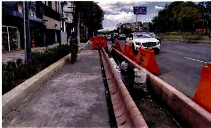
SOSTENIBLES. Las jardineras contribuirán a evitar encharcamientos en la ciclovía así como daños en la infraestructura subterránea.
