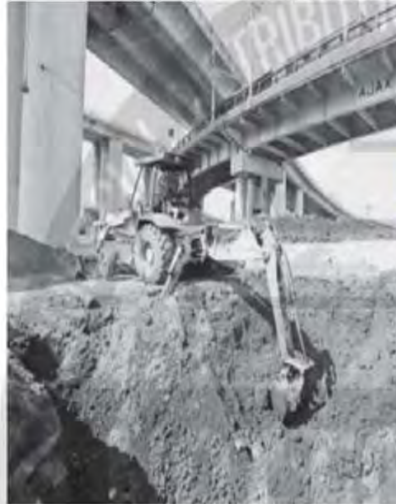
Excavaciones para evitar que la abertura crezca
