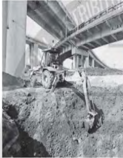
Excavaciones para evitar que la abertura crezca
