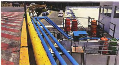
Las nuevas cisternas edificadas en el AICM buscan atender la escasez de líquido del lugar.
