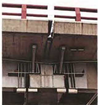
El tramo afectado presenta una separación perceptible desde el arroyo vehicular.
