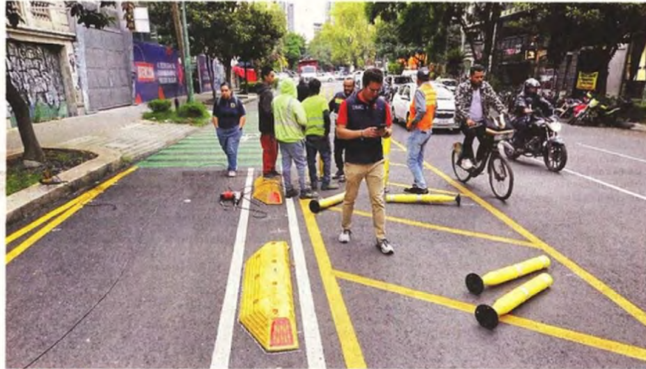
RENOVACIÓN. La Alcaldía Cuauhtémoc anunció la renovación de ciclocarriles deteriorados en las colonias Doctores y Obrera.
