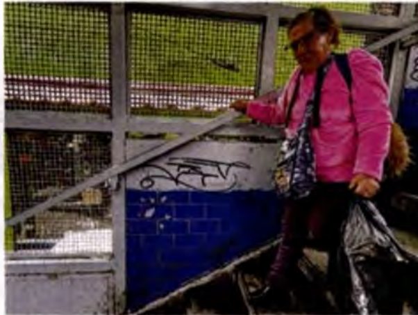
La usuaria Martha Ordóñez padece las fallas por lluvias.
