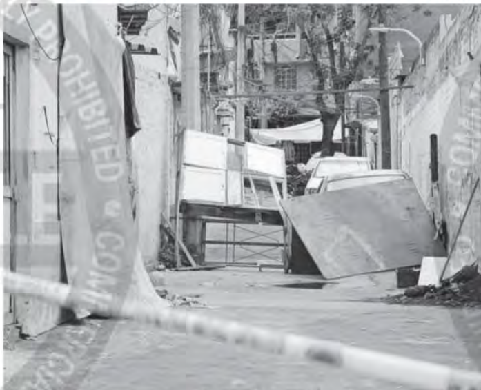
Un socavón se formó en esta casa en la colonia América este fin de semana
