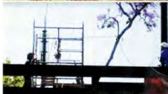
■ Aunque los tapias lucen sellos de clausura, autoridades constataron que las obras continuaron.
