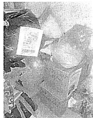
Además de filtraciones, las agencias se usan de bodega.
