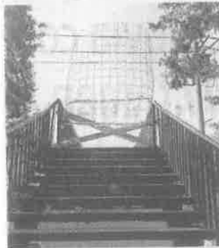
■ Los accesos al puente peatonal están inhabilitados.
