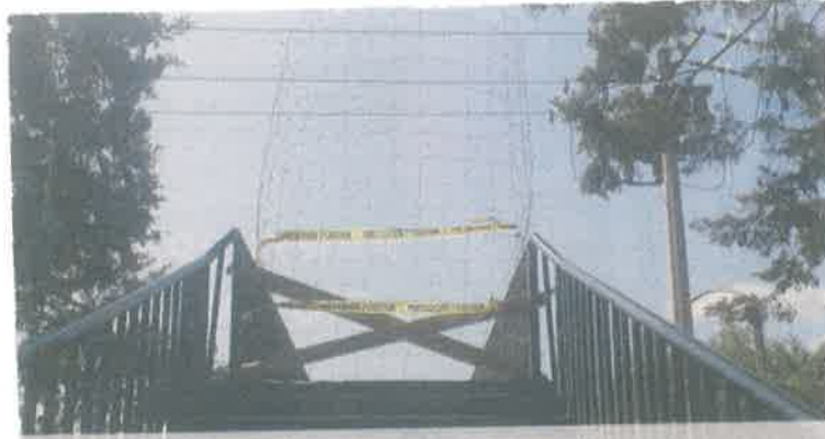
Los accesos al puente peatonal están inhabilitados por un muro de malla metálica instalado por vecinos.
