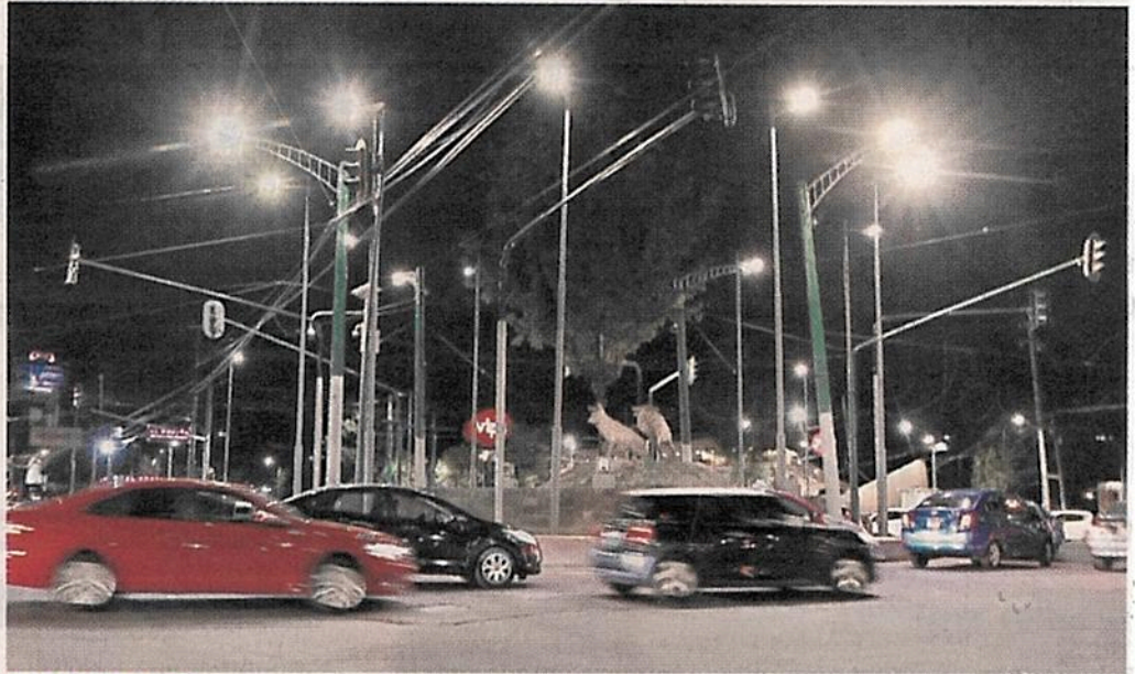
ILUMINADO. Desde ayer, el nuevo alumbrado en la glorieta comenzó a operar.
