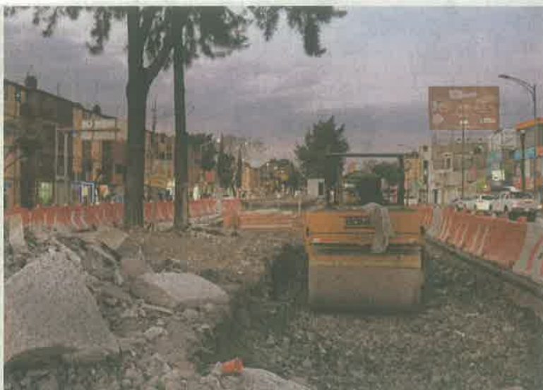
La Secretaría de Obras pagó más 2 millones 467 mil pesos para cortina metálica multiperforadora; sin embargo, 324 mil no fueron usados.
