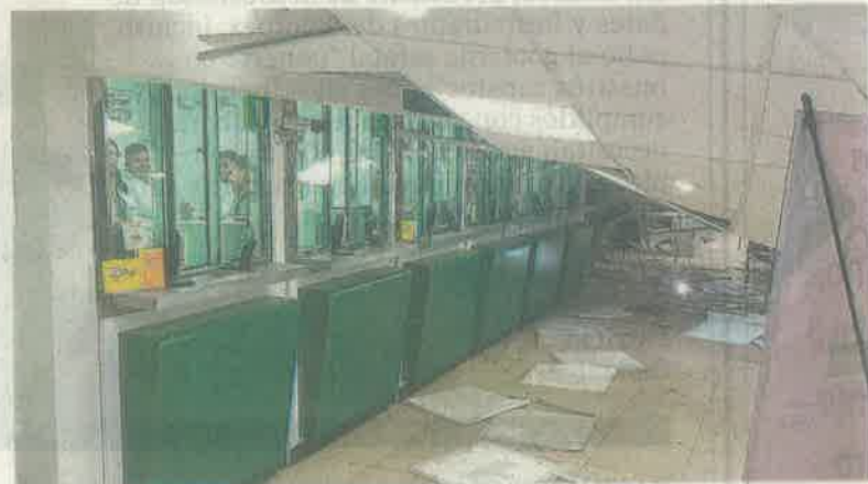
En Eje 3 Sur y Ferrocarril de Río Frío, el techo de una tienda de electrodomésticos colapsó en la zona de la sucursal bancaria.
