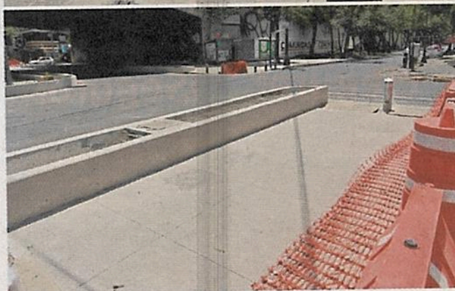
■ La renovación de aceras se realiza sobre Calzada de Tlalpan desde la zona de hospitales al Centro.
