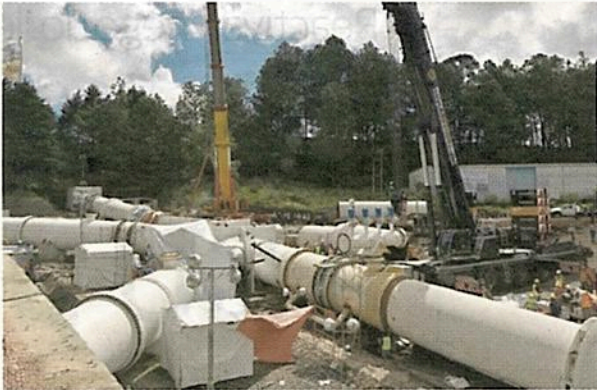
TRABAJADORES durante la instalación fallida de una pieza, durante el corte al suministro de noviembre de 2018.
