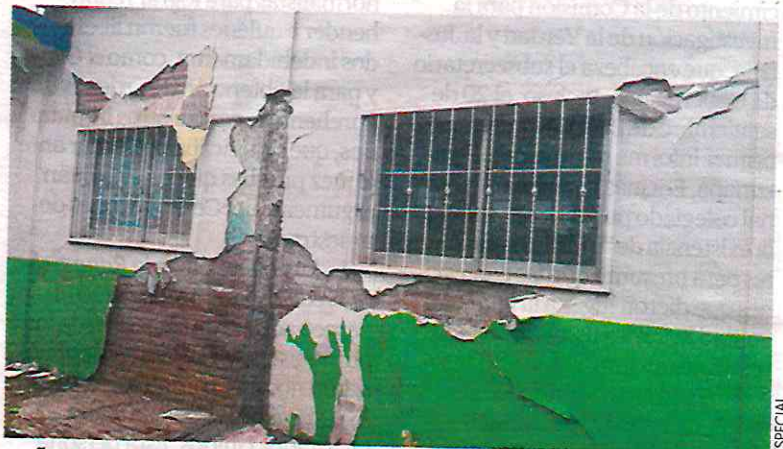
DAÑOS. Los diferentes sismos han dejado 442 escuelas afectadas en Michoacán.
